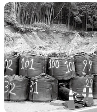
落合の崩壊現場
