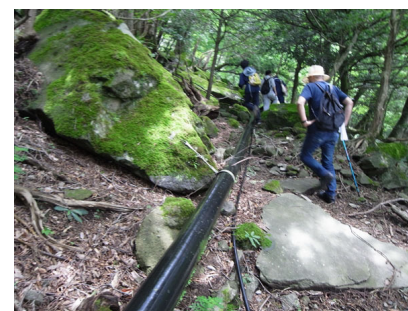
防火用水配管
