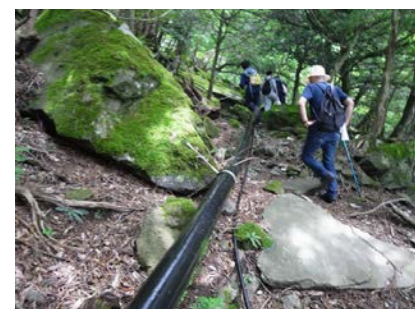
防火用水配管
