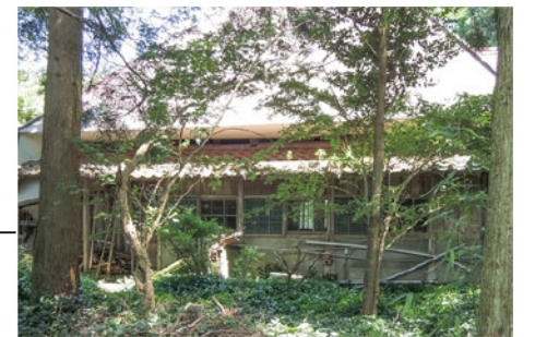
増了坊 雨漏り対策 要
