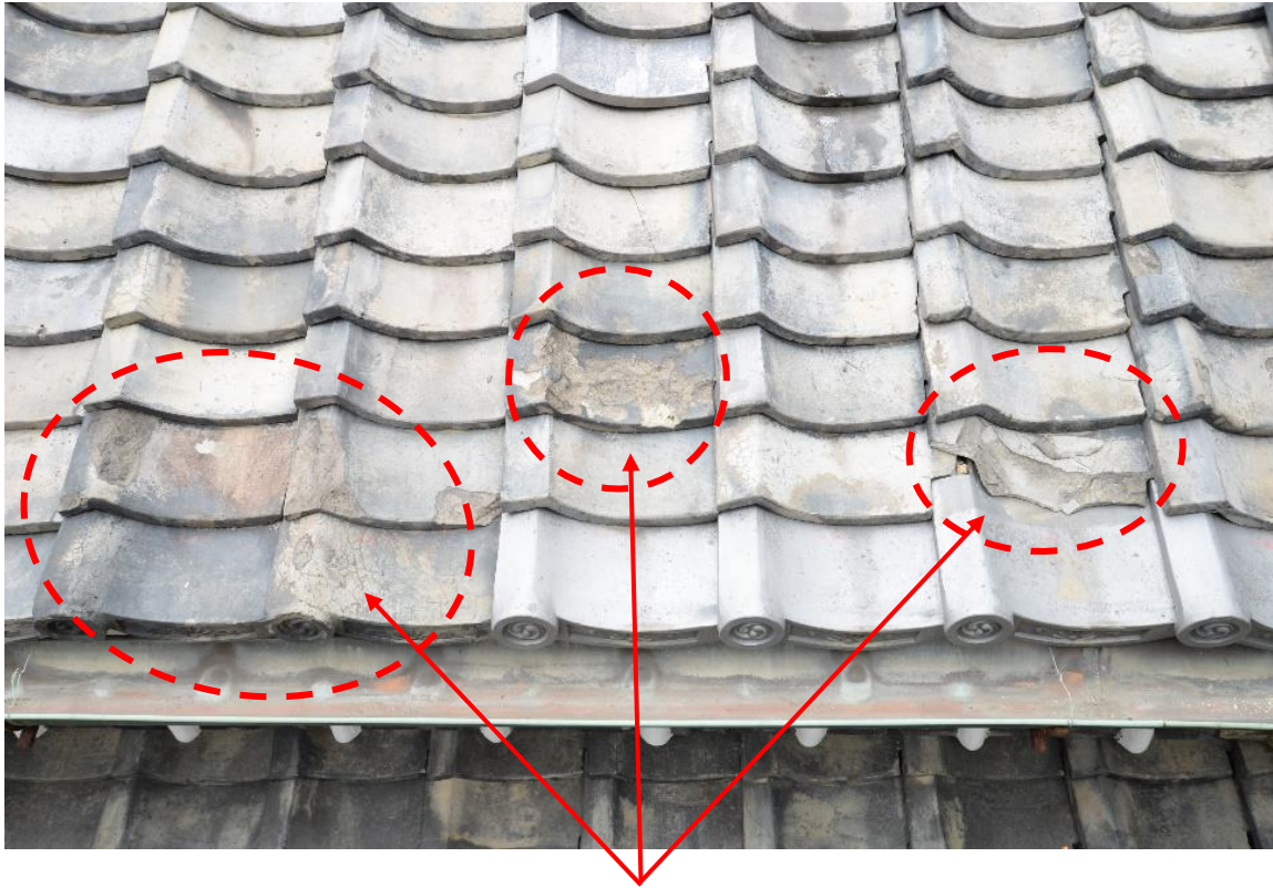
屋根瓦（取り換え前） 瓦の一部が欠けている。
