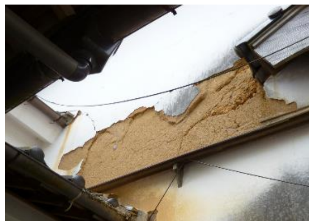
漆喰が崩落し、下地壁が見えている壁面
