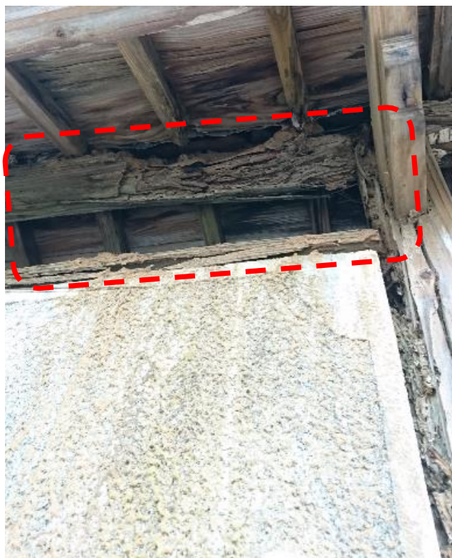
端部分から腐朽している躯体
