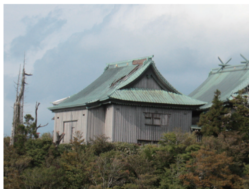
経年劣化が進行する歴史的建造物
