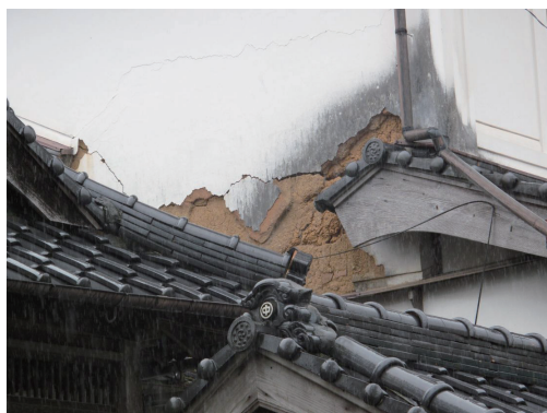
損傷が進んでいる指定文化財
