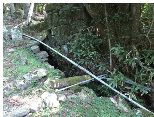
参道沿いに張り巡らされた上水用パイプ
